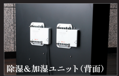
除湿&加湿ユニット(背面) 2台のユニットが自動で湿度を調整してくれる。加湿のための水供給や除水などの手間要らずなのはうれしい限りだ。
